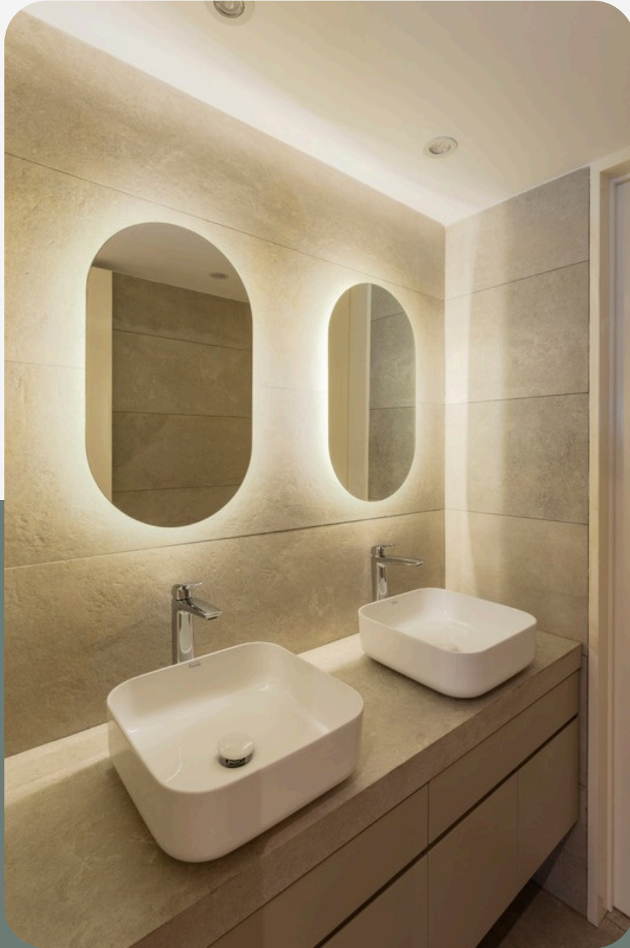
ESPEJOS RETROILUMINADOS EN BAÑOS PRINCIPALES
